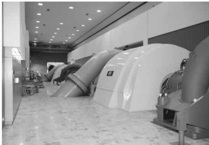
Kraftwerksguppe für Pump- oder Produktionsbetrieb (100 Megawatt) bei den Kraftwerken Oberhasli. Die Girsberger Software SILOVEDA berechnet und unterstützt die Bewirtschaftung der Grimsel Kraftwerke rund um die Uhr.
