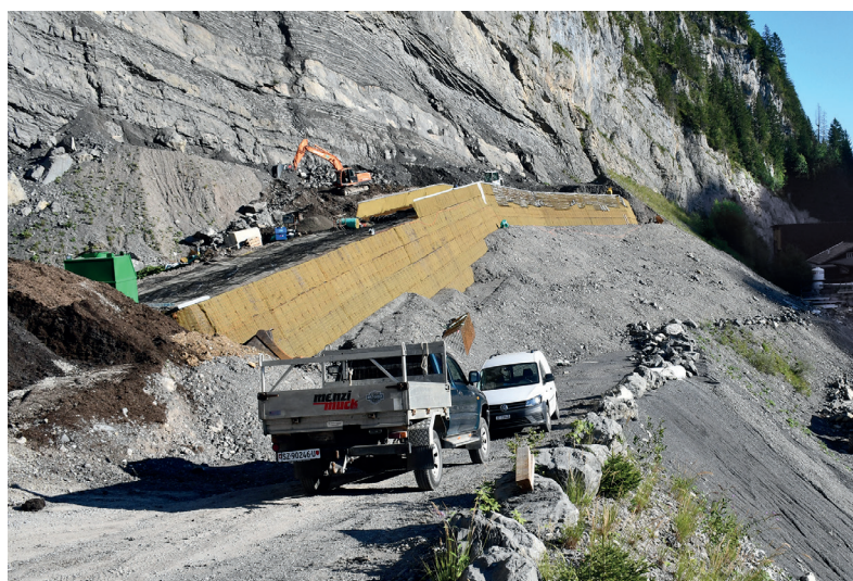
Dank dem Bau eines neuen Schutzdammes können zu den 4000 Quadratmetern weitere 3000 Quadratmeter Industrieland im ehemaligen Kieswerk Baumeli hinzugewonnen werden.
