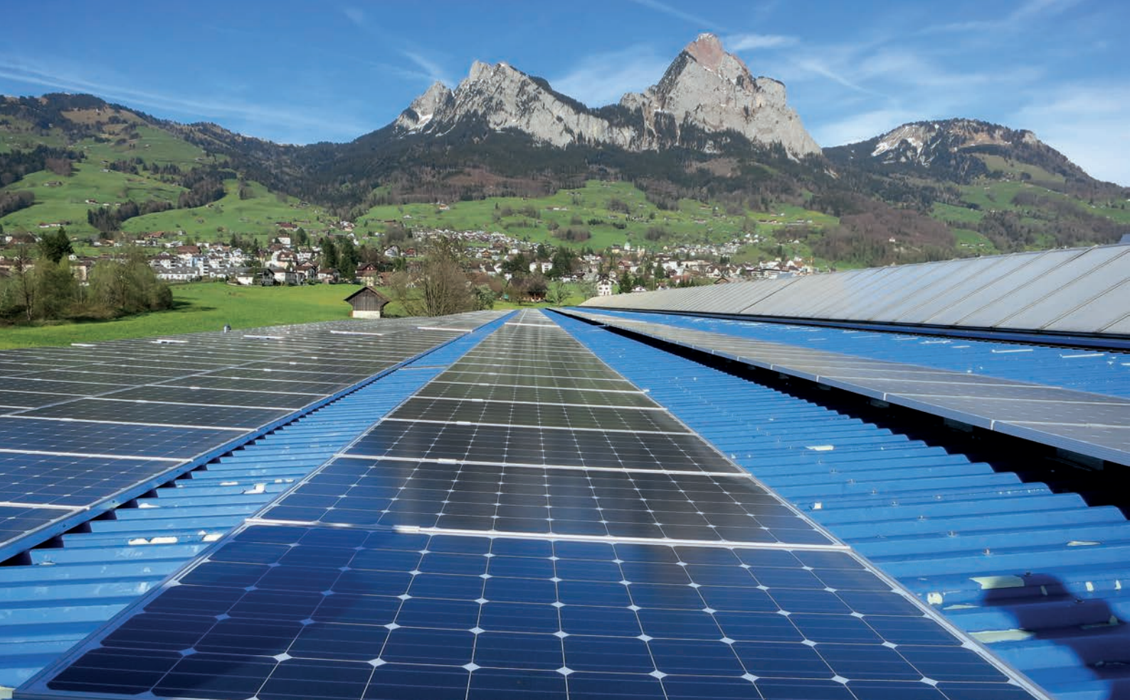
PV-Anlage auf dem Dach der Arthur Weber AG in Seewen. Bildquelle: Archiv Energiefachstelle Kanton Schwyz
