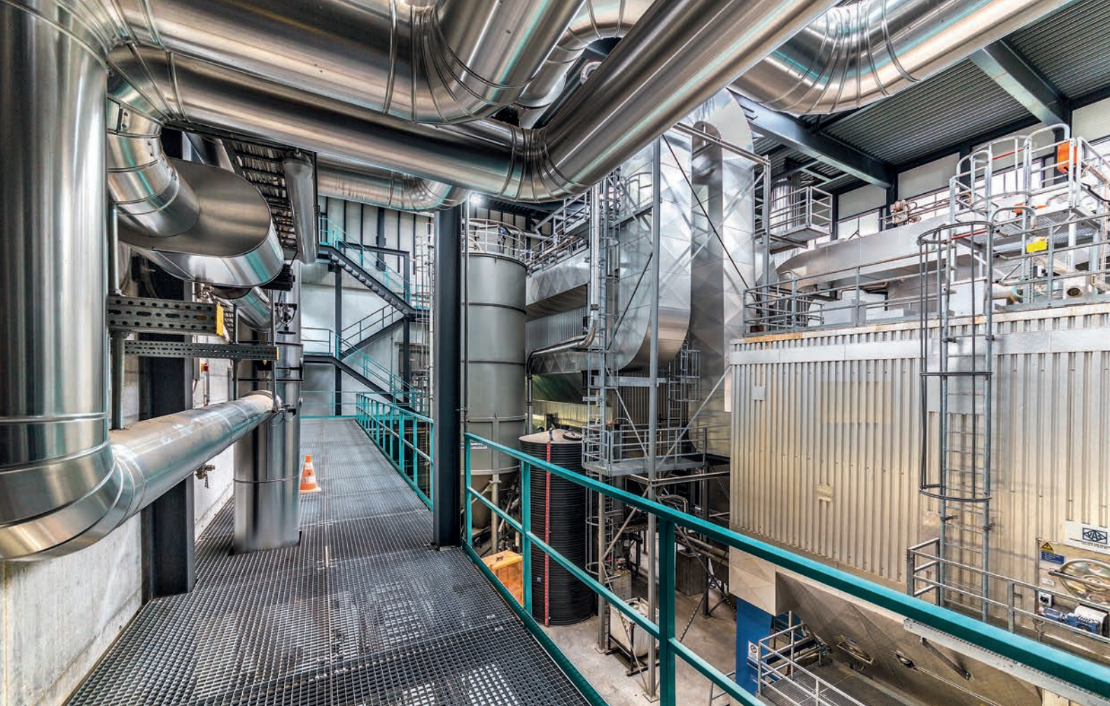
Energieeffizienz und regenerative Energien. Energiezentrale Agro Energie Schwyz.
