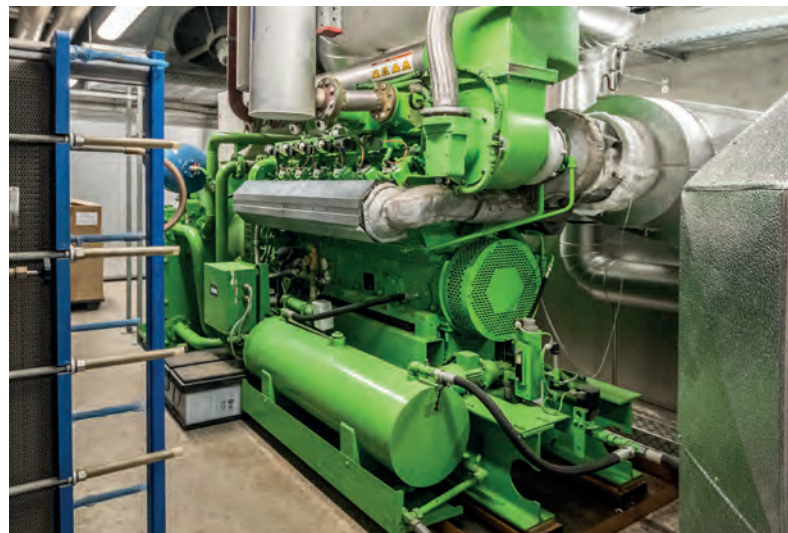
Ein leistungsfähiger Generator erzeugt Strom aus Biogas
